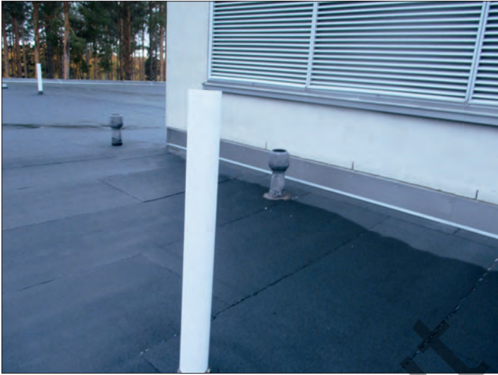
Kuva 41. Ulkoilmasäleikön riskiasennus. Riskinä on, että edessä olevasta valkoisesta tuuletuusviemäristä leviävät hajut tuulen mukana kuvassa taka-alalla oleviin tuloilmakoneiden ulkoilmasäleikköihin ja aiheuttavat hajuhaittoja sisäilmassa. Kuva: Tapio Korkala.
