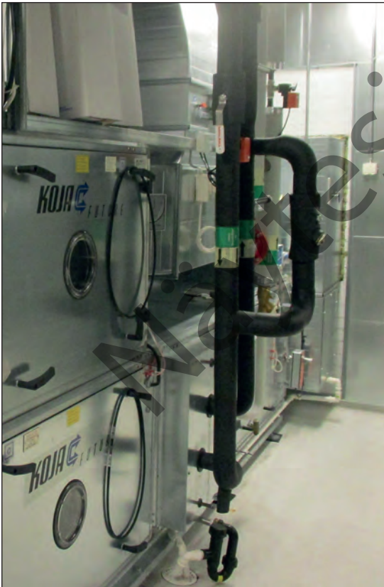
Kuva 40. Tuloilmakoneen jäähdytysosan viemäröinnissä on musta vesilukko ja taaemman osan viemäröinti on johdettu lattia-rajassa samaan konehuoneen lattiakaivoon. Kuva: Tapio Korkala.
