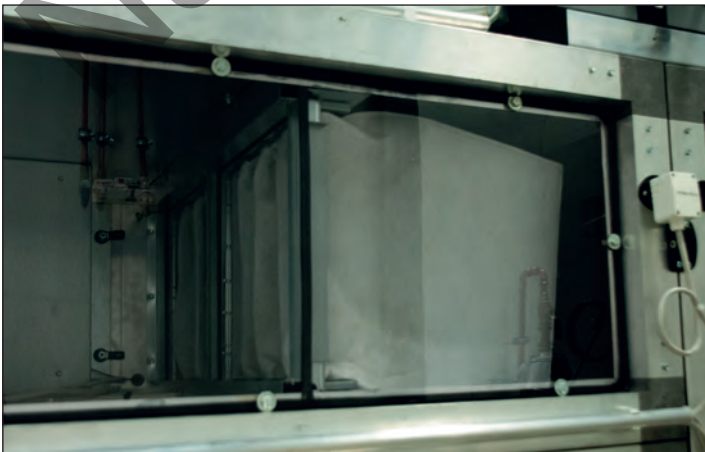
Kuva 46. Suodattimia tuloilmakoneessa. Kuva: Tatu Käpymäki.
